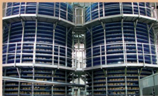
■ Installation industrielle double tour
